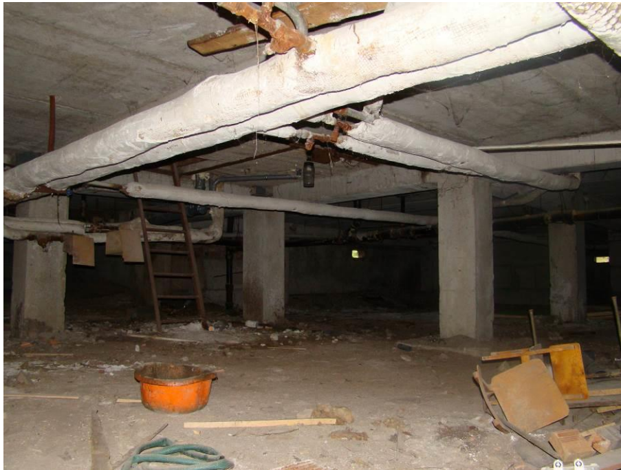
5.att. Pagraba pārsegums apmierinošā stāvoklī, tomēr to siltuma caurlaidības koeficients ir augsts un to ieteicams nosiltināt Cauruļu siltumizolācija novecojoša
