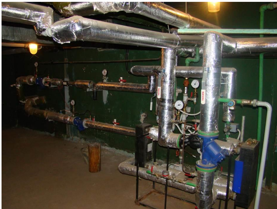
6.att. Ēkā uzstādīts automātisks siltummezgls..
