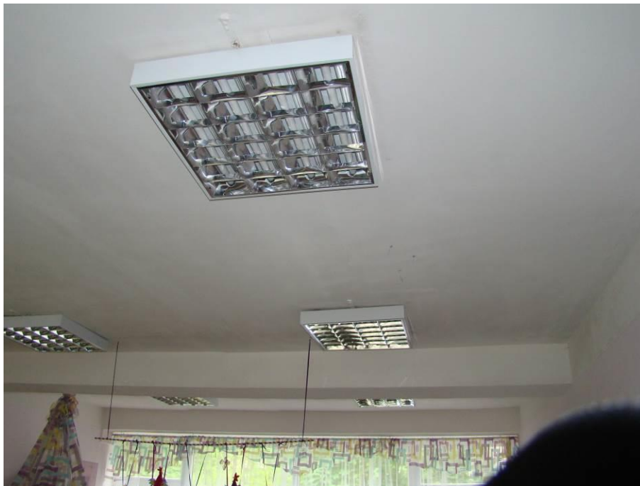
4.att. Ēkas apgaismojumam izmanto gan luminiscētas spuldzes gan kvēlspuldzes
